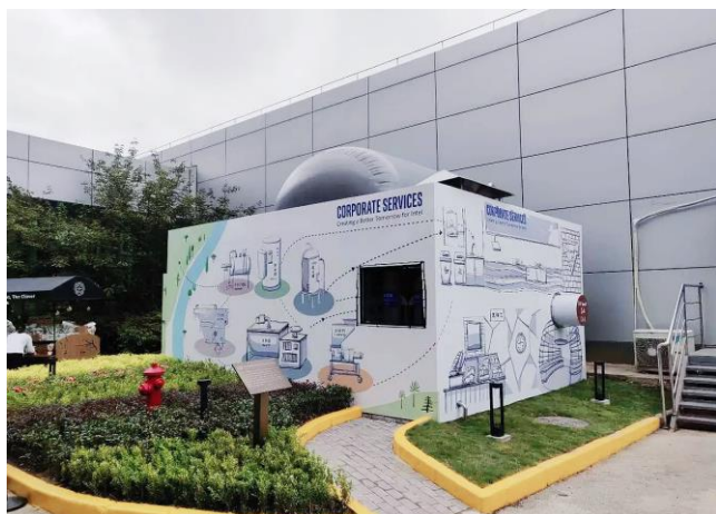
上海闵行 餐厨垃圾处理项目
